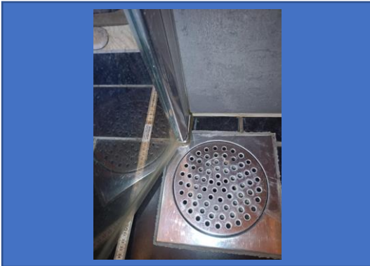
Bild 9: Golvbrunn för nära vägg, dusch/wc.
