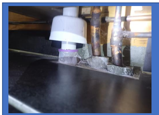
Bild 4: Otäta rör genomföringar i golv, dusch/wc/bastu.
