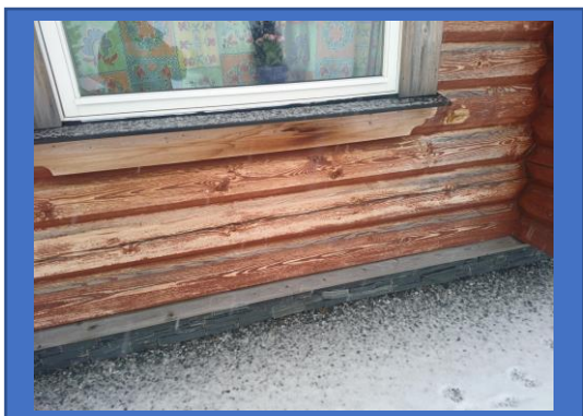
Bild 1: Torrsprickor på timmer, målningsbehov.
