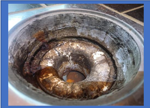
Bild 7: Utrymme mellan klinkerram och klämring igenfyllt med fix, tvättstuga.
