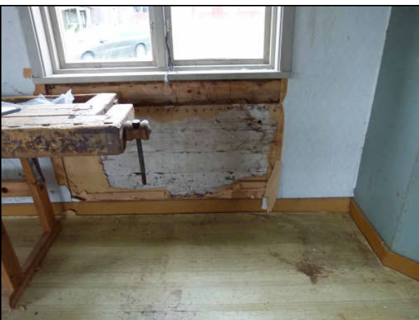
MG_I_102_012. Väggen under fönster i den sydvästra fasaden.
