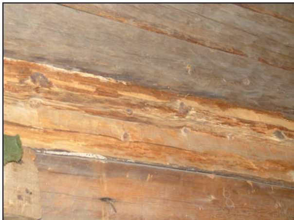
AA_I_004. Skador i timret på väggen mot nordost.
