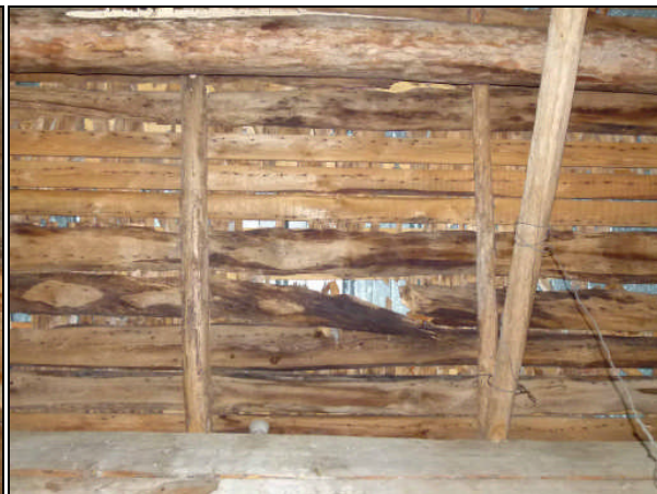
AA_I_005. Rester av spåntak finns under plåten.
