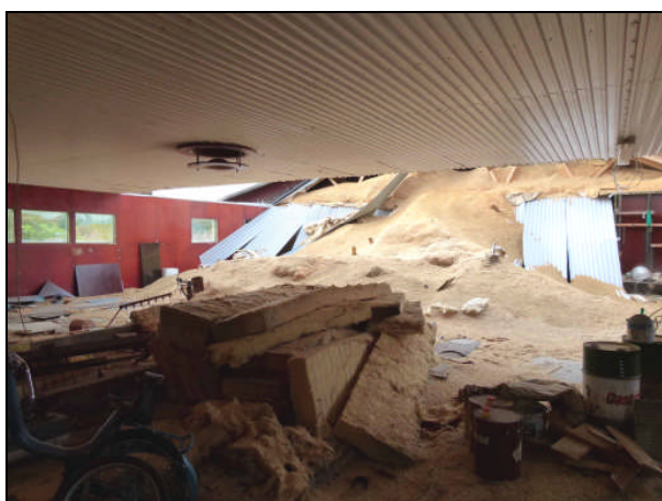
LA_I_002. Det nedrasade taket i mittenrummet. Mot väster.
