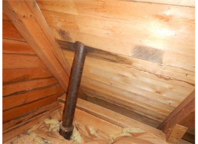
Fuktfläck på underlagstak vid avloppsventilationen.
