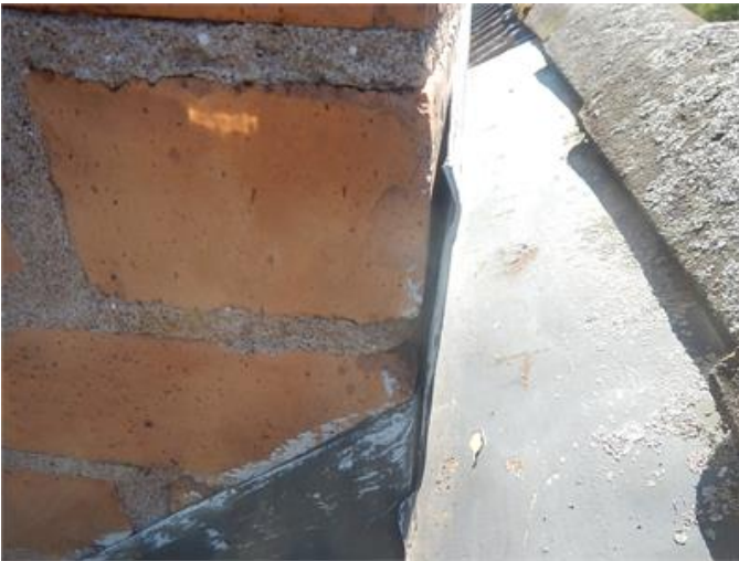
Otätthet vid skorstensbeslag mot murstock tak.
