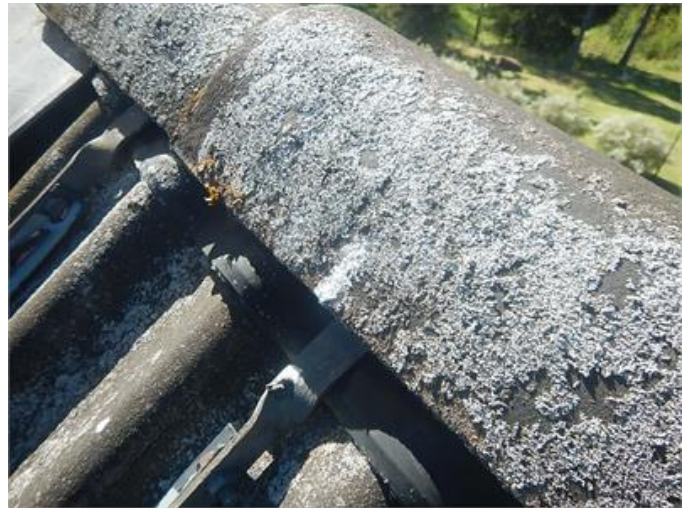
Påväxt med lav på tak.
