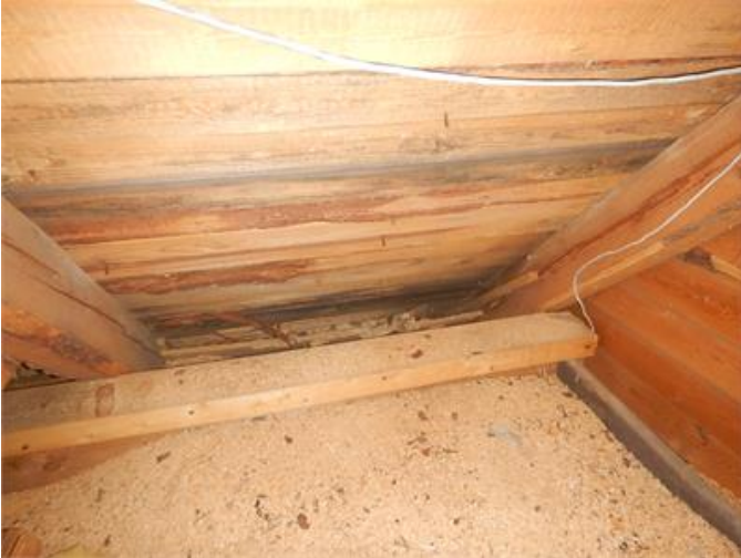
Mikrobiell påväxt på underlagstak vind.
