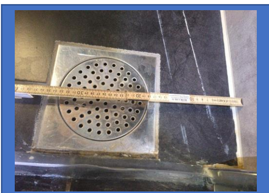
Bild 5: Golvbrunn för nära vägg, dusch/wc/bastu.
