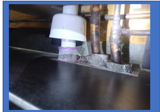
Bild 4: Otäta rör genomföringar i golv, dusch/wc/bastu.
