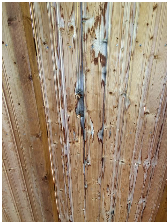
Fukt/missfärgningar på innetakspanel uterum
