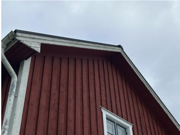
Bristfälligt underhåll vindsживor
