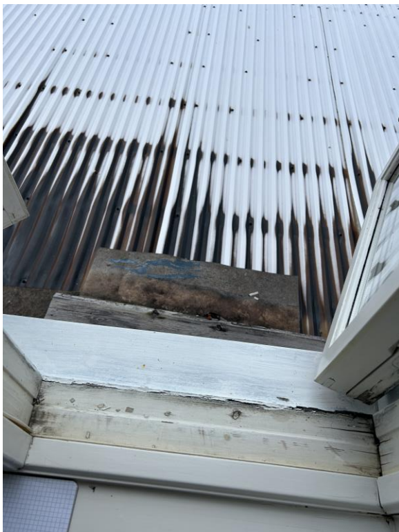
Plasttaket på uterummet samt rötskadat karmbottenstyck i sovrum öster
