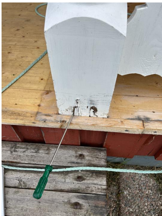
Rötskada räckesstolpe entrésidan
