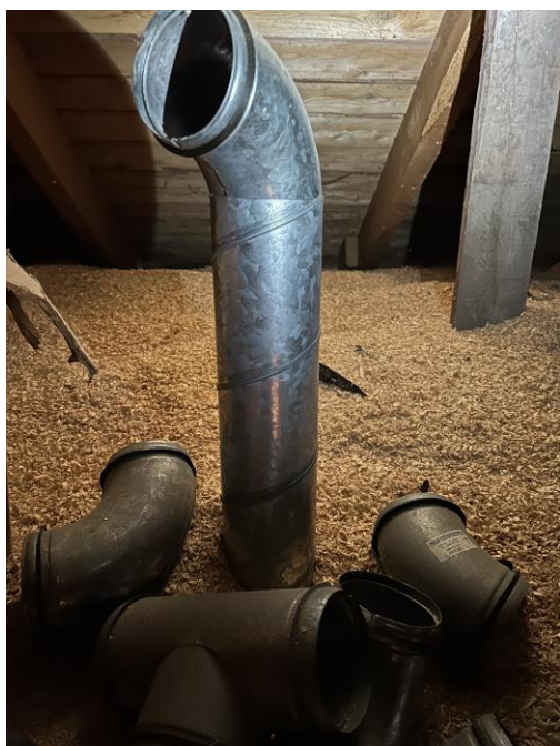
Ventilation från badrum mynnar ut i vindsutrymmet
