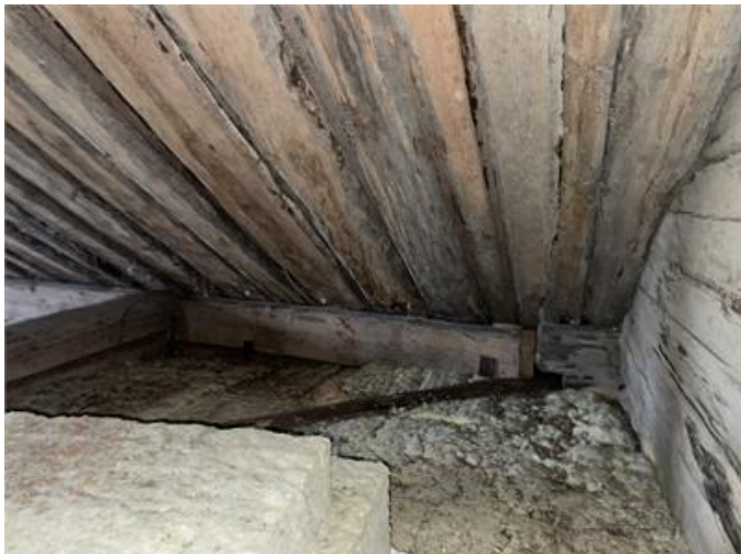
Vind med gamla fuktmärken
