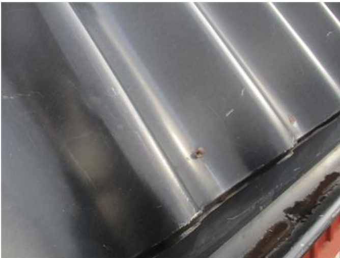
Yttertak med brister
